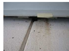
壁の隙間から落とされるコウモリの糞による汚損被害
