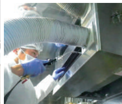
エアコン洗浄
